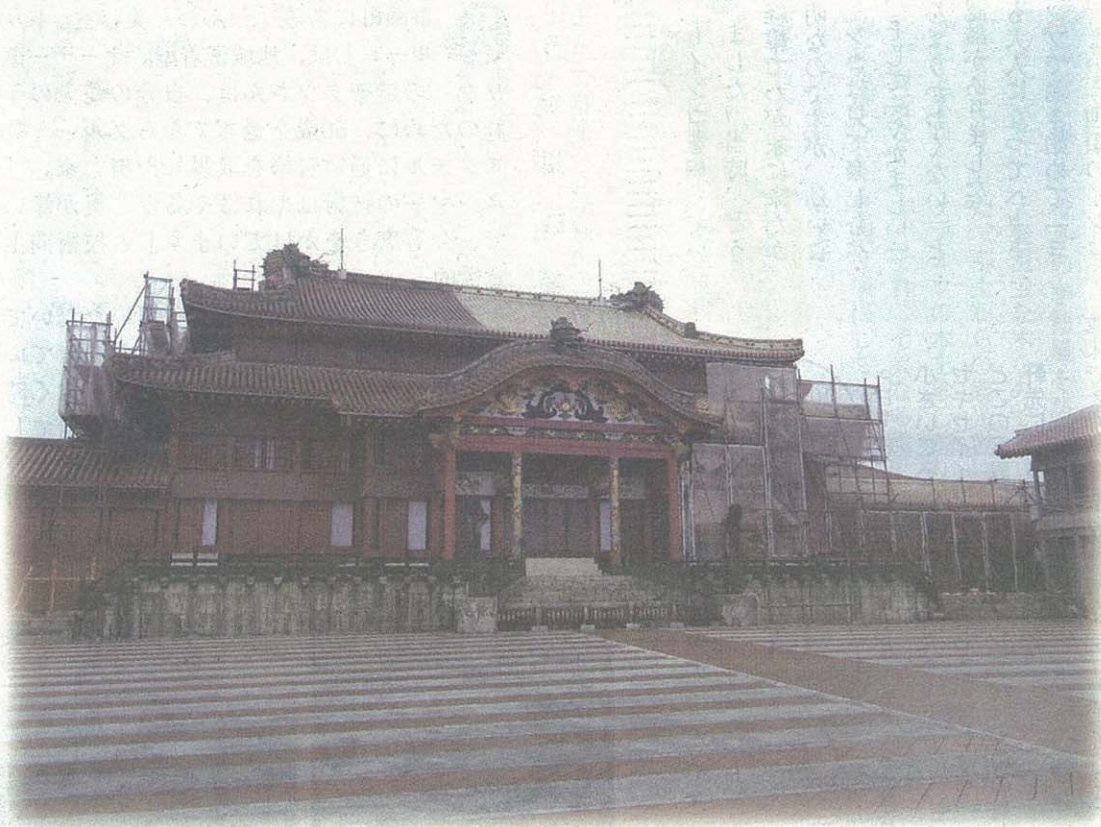
首里城正殿の屋根漆喰の補修工事と外壁塗装の塗り直し工事
